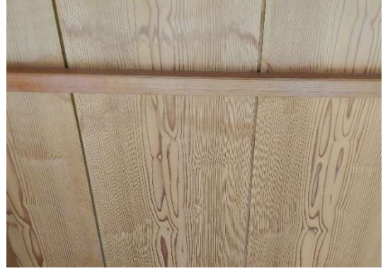
客室 天井のシミ
