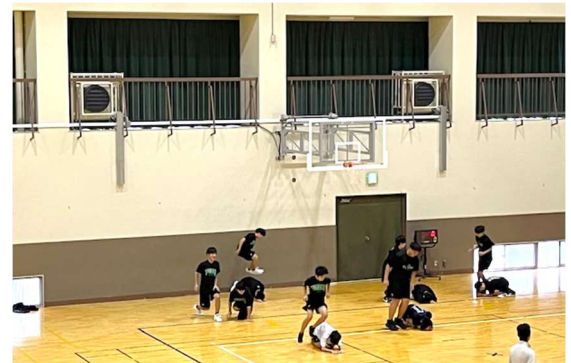
▲2024 年度に空調設備を整備した中学校の屋内運動場
