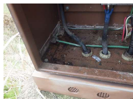
▲絶縁端子の不良
