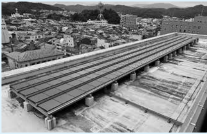
▲市役所本庁舎屋上の太陽光発電設備
