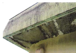
外装劣化状況(塗装剥がれ)
