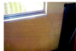
内装劣化状況(クラック)
