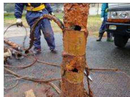
▲揚水管の腐食
