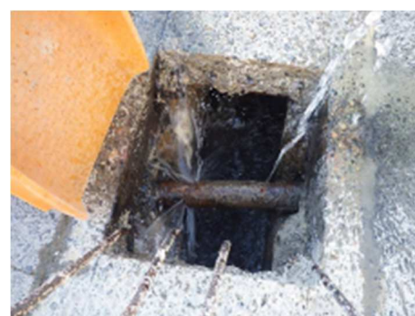
▲送水管の破損
