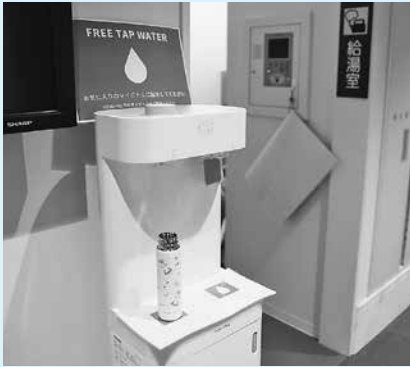
▲稽古堂に設置したウォーターサーバー。マイボトルを持参すれば、水分を補給できる
