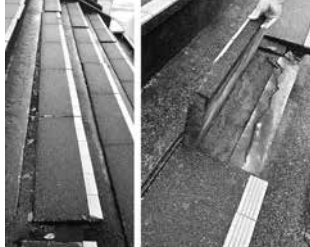
劣化が進む陸上競技場のスタンド
