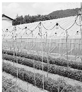
光中断のLED設備
