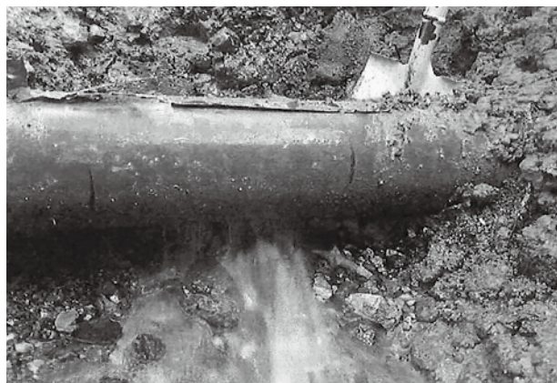
市道地下埋設管から漏水 (2021年、豊岡市内)
