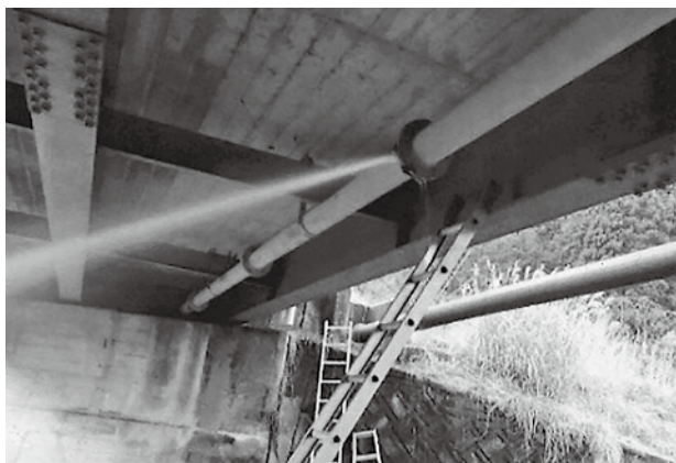
老朽化による配水管からの漏水 (2018年 豊岡市内)
