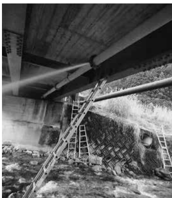
配水管からの漏水。老朽管の更新 の必要性は理解できるが...
