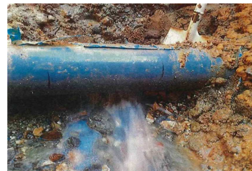
市道地下埋設管からの漏水 (2021年 豊岡市内)
