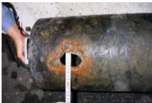
腐食して穴が開いた管 (出典：公益社団法人 日本水道協会)
