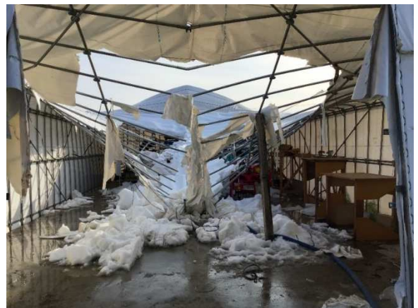
大雪により倒壊した農業用倉庫 担当課名【農林水産課】（内線 2361）
