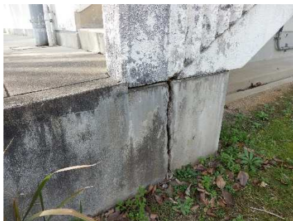
D判定：コンクリートのひび割れ (神美小学校)
