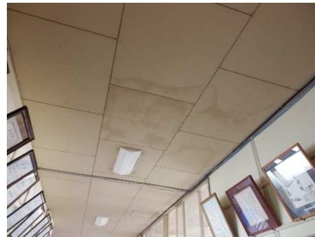
C判定：天井漏水あと (日高東中学校)
