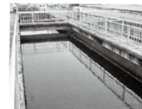
⑤最終沈殿池
