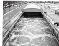
④エアレーションタンク
