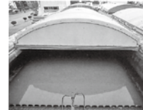
③最初沈殿池
