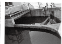
⑥塩素混和池
