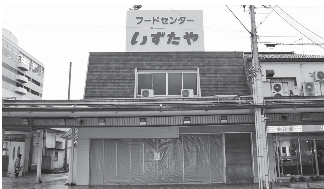
傾きが発見された生涯学習サロン予定建物
