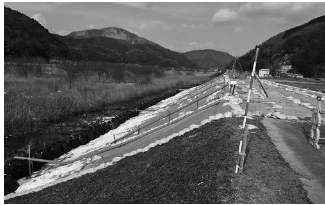
応急処置され復旧工事が待たれる円山川堤防のり面亀裂区間
