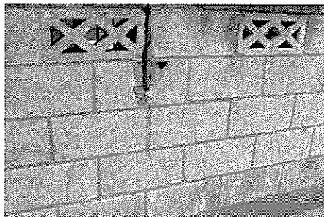
塀に大きなひび割れが生じている
