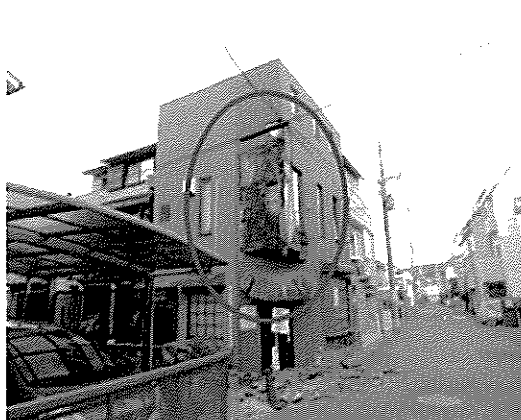
外壁が破損している
