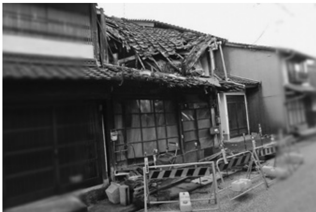
放置されている危険な空家
