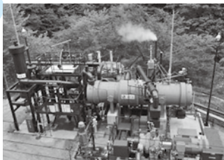
バイナリー発電所(福島県福島市)
