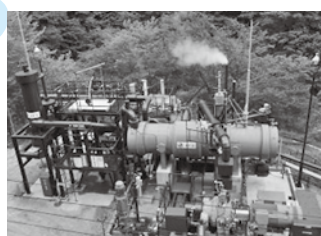
バイナリー電源16号温泉土湯(福島県福島市)
