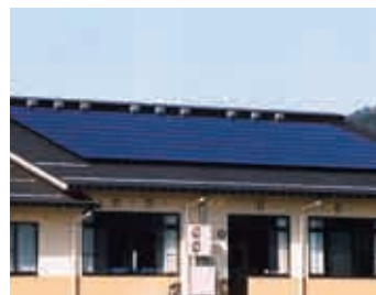
市の施設に設置した太陽光発電パネル
