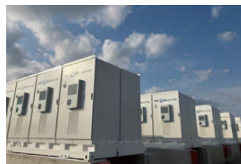
豊岡中核工業団地内に設置した太陽光発電設備・蓄電池設備 出典: (株)カネカ WEB サイト
