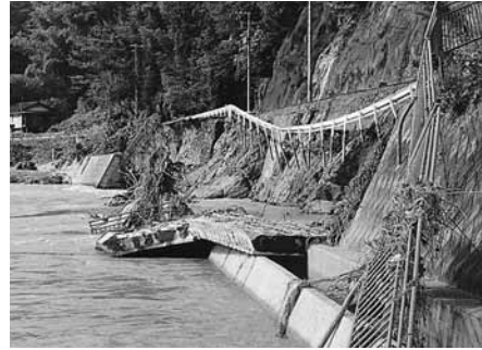
歩道が崩壊した主要地方道日高竹野線（森本区内）。災害に強い幹線道路の整備が待たれる
