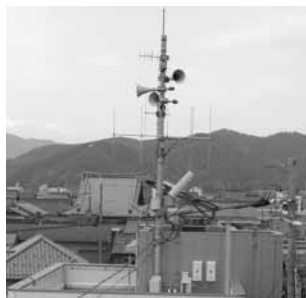
市役所防災通信センターにある屋外拡声装置
