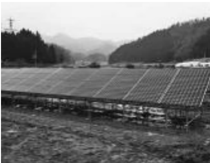
▲設置した太陽光発電設備
