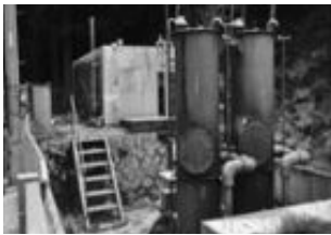
坂野簡易水道
