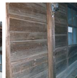
開口部 摺り上げ戸 すりあげど
