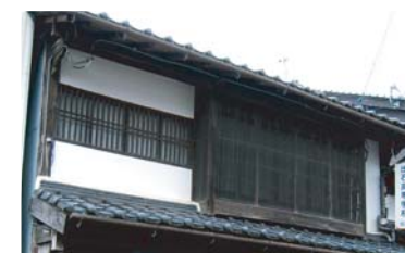
参考-真壁の2階外壁 左官仕上げの真壁は、出石における標準的な2階の外壁です。簡素ですが、町並みに軽快なイメージを与えます。
