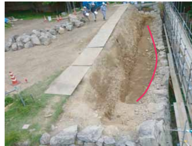
① 裏込めへの土砂の流入
