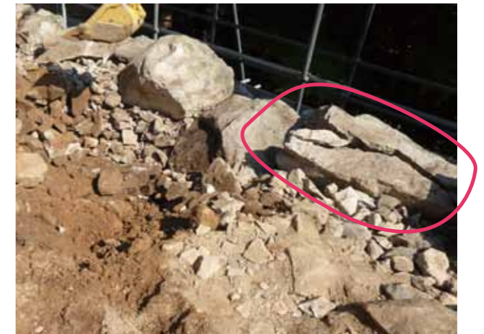
② 築石の割れ (胴割れ)
