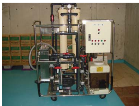
非常用給水装置
