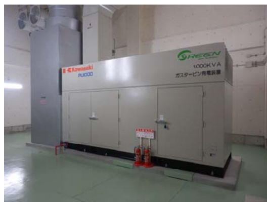
ガスタービン発電装置（佐野浄水場内：1000KVA）
