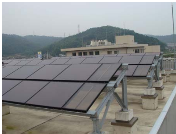
太陽光発電設備 (佐野浄水場内)
