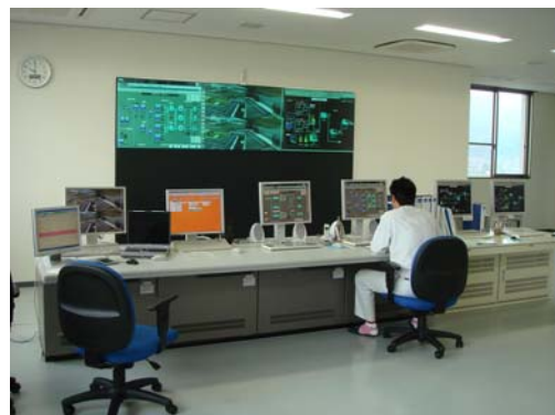
中央監視、制御システム
