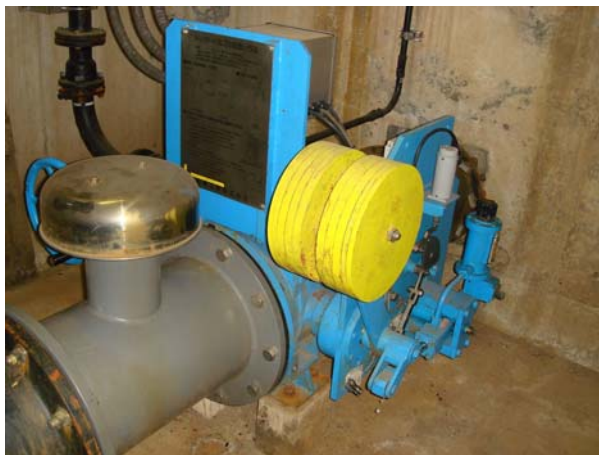
緊急遮断弁（大篠岡配水池の場合）
