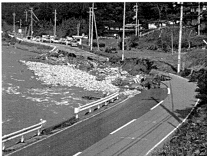
▲但東町栗尾 崩落した国道426号
