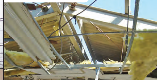
(独)建築研究所提供 2006.9 宮崎県延岡市
