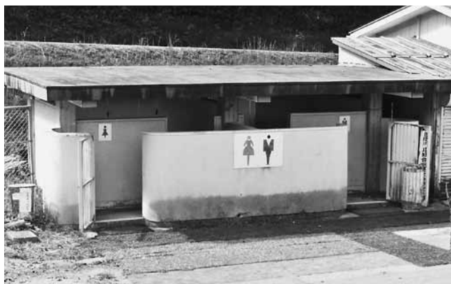
改修が望まれる陸上競技場のトイレ
